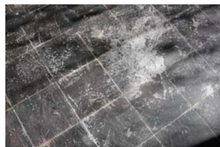
Abb. 5: schwarzer, asbesthaltiger Bodenbelagskleber
